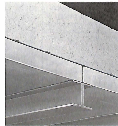
Befestigungsbeispiel für die Verstärkung von Decken: Die Elemente liegen auf dem stützenden Eisenprofil auf und bilden somit eine feste Verbindung mit dem Mauerwerk.
