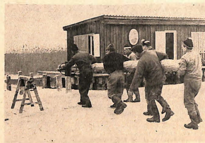
Seehütte des GSV Burgenland in Rust: Arbeiten für den Zubau am zugefrorenen Neusiedler See.
