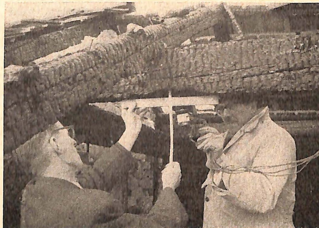
Das ausgebrannte Stapaflex-Rohr. Der Metallschlauch in einer Länge von rund 2 m hatte drei starke Schweißstellen; die Durchbrandlöcher zeigten Längen von 5 bis 7 cm
