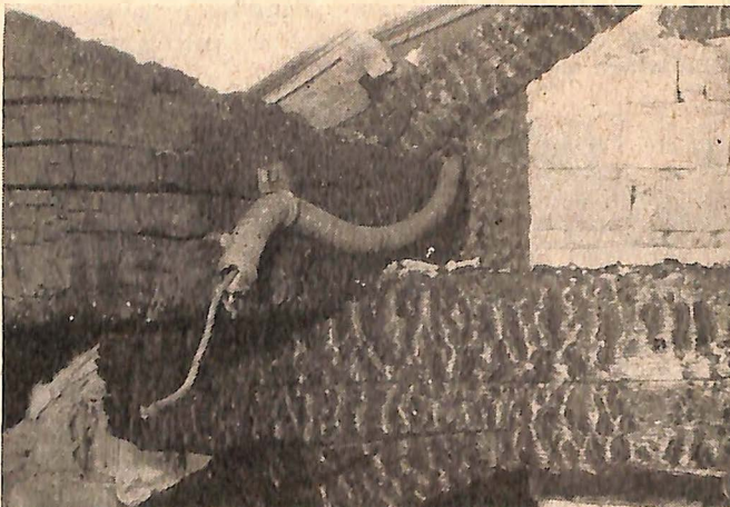
Die Dachpfette unterhalb der Panzersicherung zeigte eine besonders tiefe Verkohlung von 4 cm, die nur durch die Bildung eines Lichtbogenkurzschlusses entstanden sein kann
