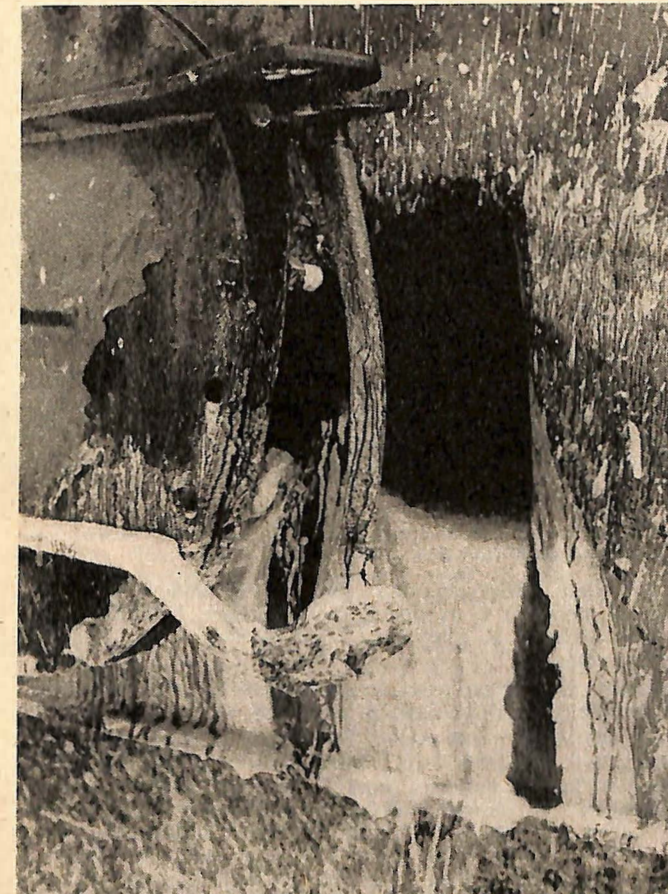
Der beschädigte Solebehälter
