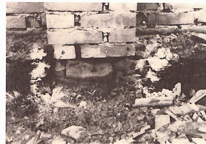
a) Mauerziegel zwischen Kaminschacht und Tram — b) Winkeleisen zur Abstützung des Kamins
