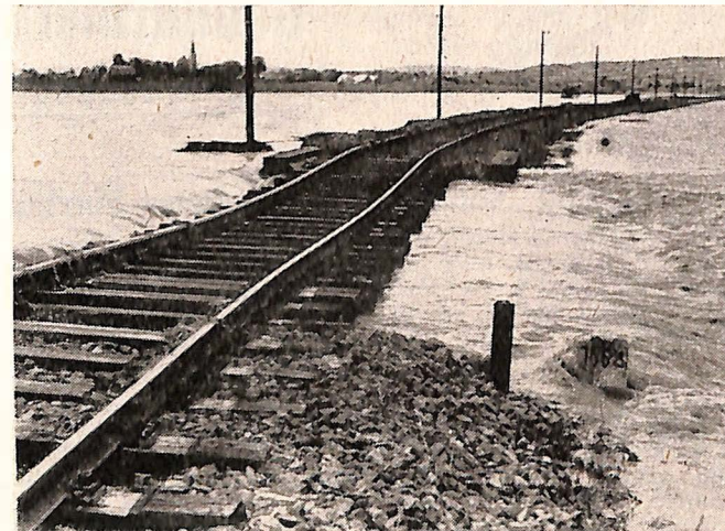
Zwischen den Bahnstationen Haugsdorf und Alberndorf wurde der Bahnkörper in einer Länge von mehr als 20 Meter fortgeschwemmt, so daß die Gleise frei schwebten
