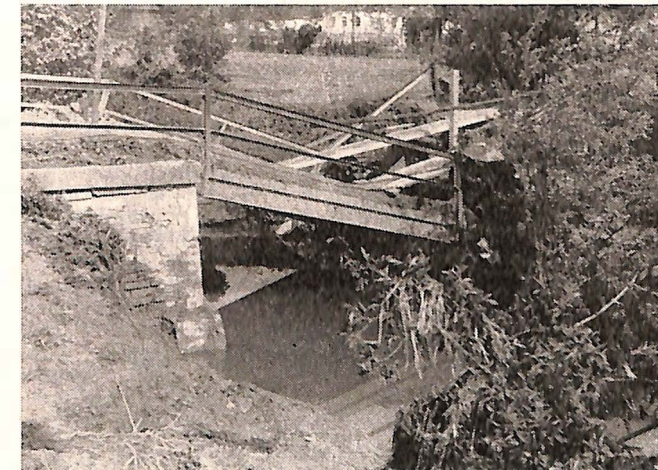
Eine vom Hochwasser zerstörte Brücke im Ortsbereich von Oberfellabrunn
