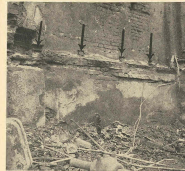
Die Brandausbruchsstelle. Der Pfeil zeigt die Auflager der einzelnen Deckenträger. Die Sägespäneblöfungen zwischen den Trägern an der Mauer sind zu erkennen. An der Deckenuntersicht unmittelbar an der Mauer war die Vorrührerleitung und die Leitung zur Nagelmaschine montiert. In die Mauer teils eingestemmt, teils herunterhängend alte Licht- und Kraftleitungen.
