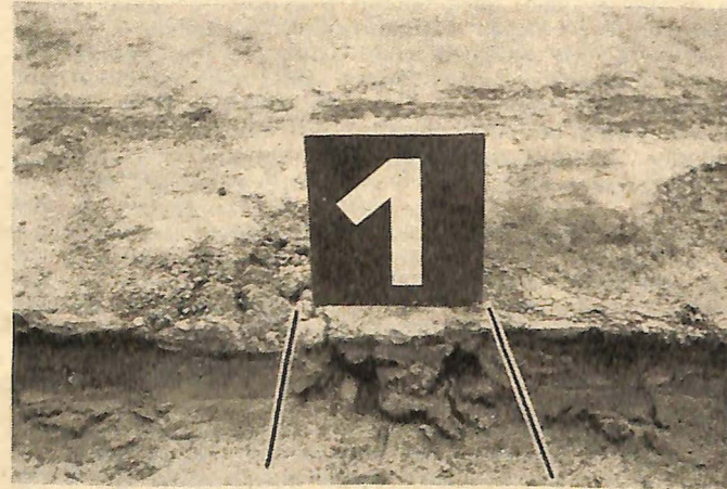
Mauskanäle, welche den Brand herbeiführten — Brandausbruchsstelle
