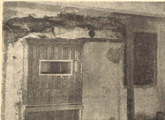
Brand durch Baumängel verursacht
