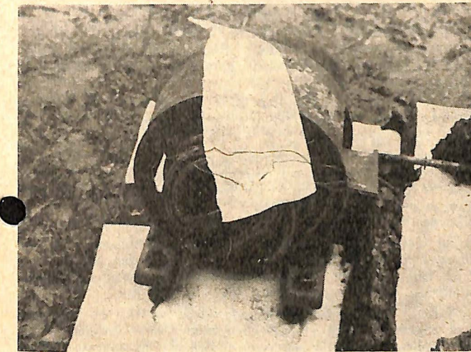
Alter 4-PS-Drehstrommotor mit Kurzschlußläufer in halb offener Bauart, der zum Antrieb einer Kreissäge verwendet wurde. Vollkommen ausgebrannte Ständerphasenwicklungen, die an zahlreichen Stellen in primitivster Weise geflickt waren. (Enden, wie im Bild zu erkennen, einfach zusammengedreht oder nur hakenförmig umgebogen und so zusammengehängt, wodurch Wackelkontakte entstanden.)
