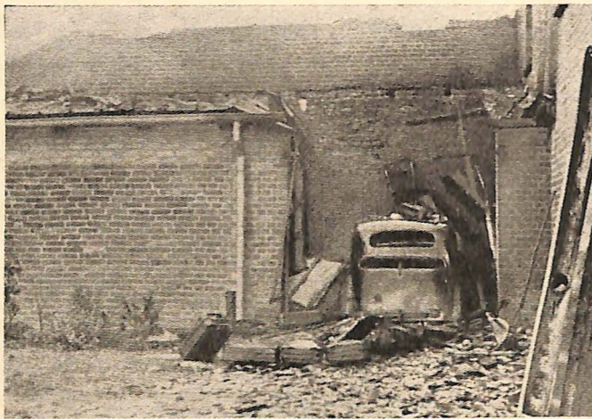
Bild 3: Wenige Minuten später stellte man fest, daß es auch in der Garage brannte, die von dem brennenden Gebäudeteil allseitig durch Brandmauern getrennt war
