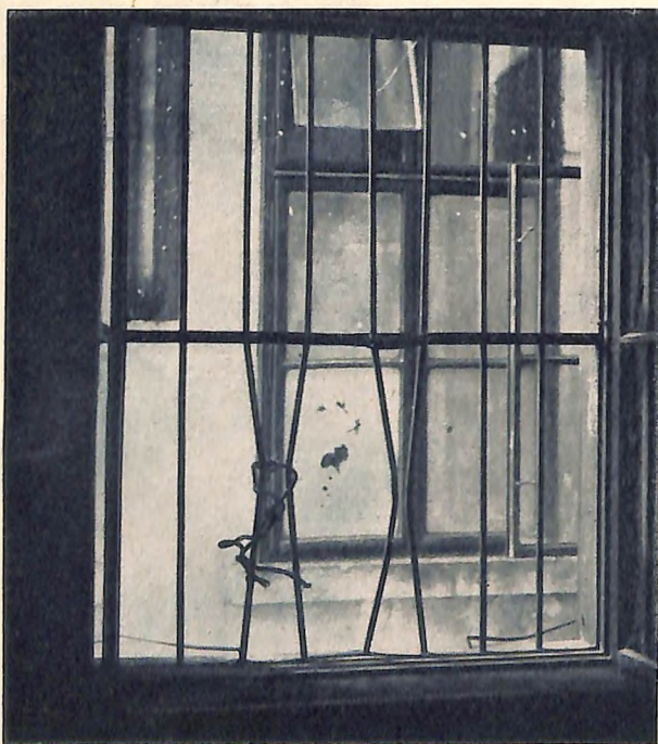
Das Fenster, dessen Gitter die Verbrecher mit Hilfe eines Striches und einer Eisenstange auseinanderbogen, um in die Räume des Steueramtes in Gänserndorf einsteigen zu können.
